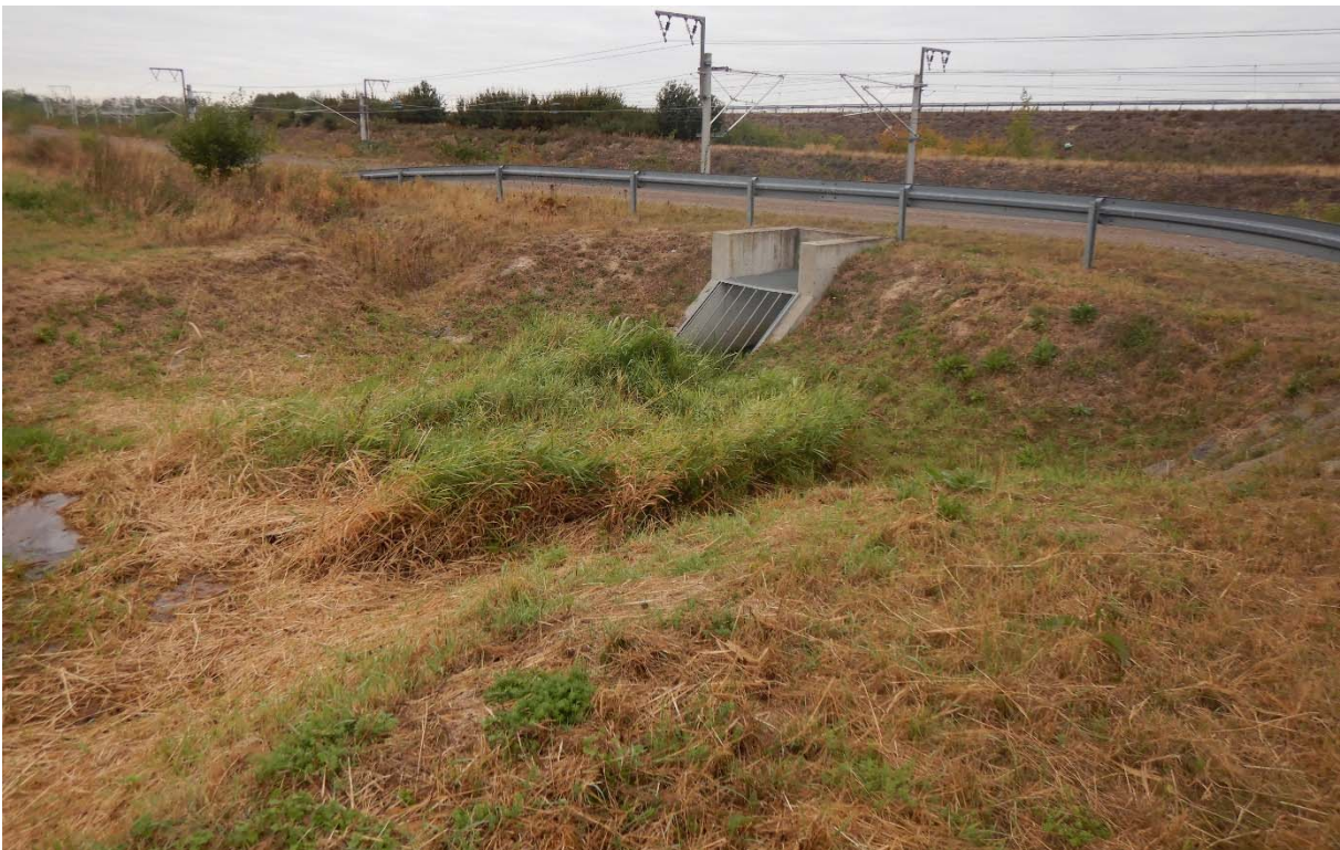
Abbildung 11 Ahe-Süd: Einlauf Düker Manheimer Fließ unter Hambach-Bahntrasse
