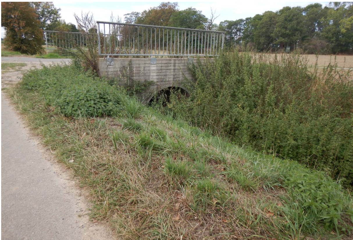
Abbildung 29 Wiebach: Durchlass für den Wiebach unter der L276 zwischen Thorr und Ahe
