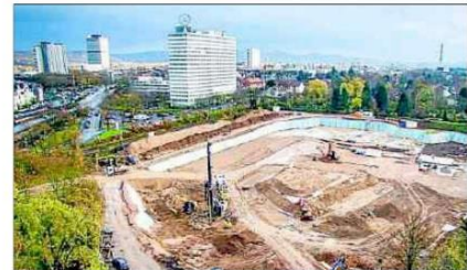
In Bonn wird – anders als hier an der Reuterbrücke – insgesamt zu wenig gebaut. Foto: Volker Lannert
